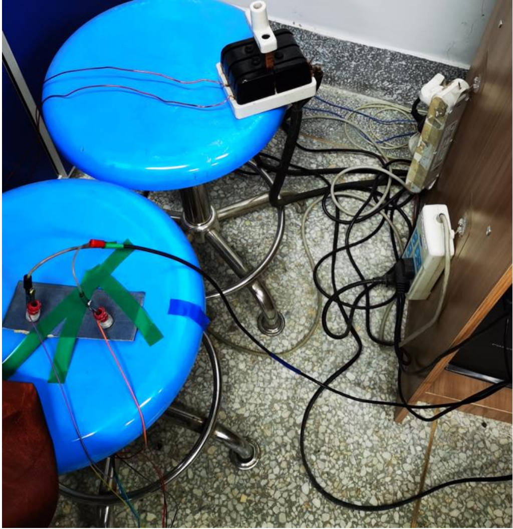
图四：串接插座、混乱接线
