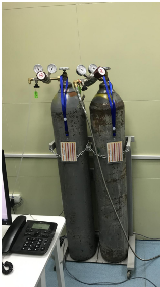
图 3. 格致楼 1037-2 三个气瓶均无防震胶圈。
