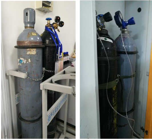
图 7. 格致楼 1037-1 气瓶无防震胶圈隐患已整改。
